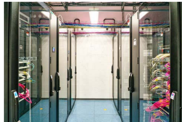
Serverschränke im RZ-Nord
