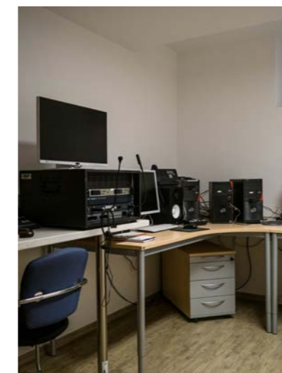
Technikraum in Zwiesel
